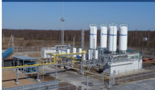
КСПГ, г. Псков
